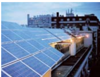
Modules photovoltaïques installés sur le toit terrasse d'un bâtiment HLM à Montreuil (puissance totale 22 kWc).
